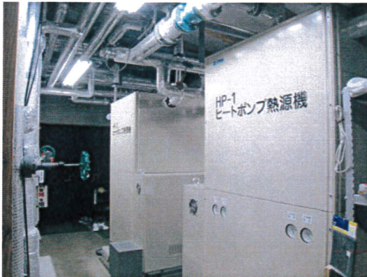
写真5 熱不足分を補うヒートポンプ設備
